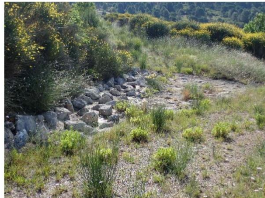
Illustration 39 : Caniveau de gestion des eaux et zone de réception en enrochement
