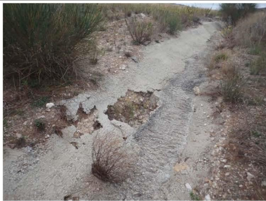
Illustration 7 : Dégradations du béton dans le caniveau longeant la RD111
