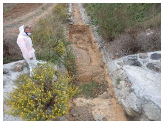
Illustration 17 : Accumulation de sédiments dans le bassin aval du dégrilleur
