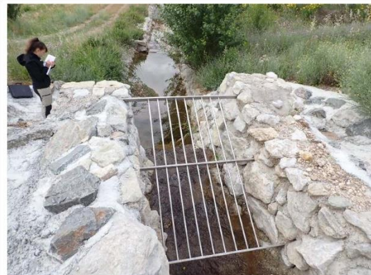
Illustration 28 : Amont du dégrilleur, en bon état
