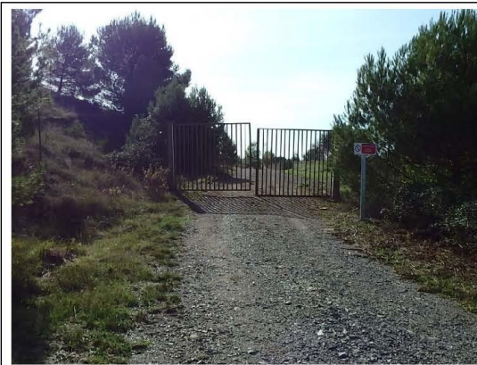
Illustration 25 : Portail d'accès au site de l'ARTUS, dégradé
