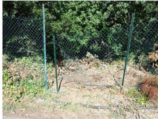
Illustration 37 : Brèche dans la clôture au niveau du bassin n°6
