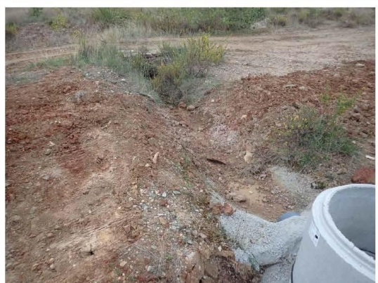
Illustration 18 : Reprise de l'exutoire de la source Arsine à l'occasion des travaux de canalisation des eaux du point V
