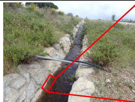
Illustration 29 : Dépôts dans le caniveau bétonné
