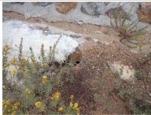
Illustration 8 : Début de sous-cavage sous le caniveau longeant la piste d'accès
