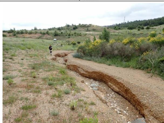
Illustration 18 : Caniveau d'amenée des eaux à la mare B2, dégradé
