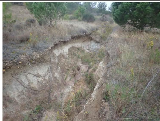
Illustration 10 : Caniveau d'amenée des eaux à la mare RM2, fortement raviné
