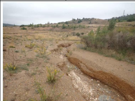
Illustration 6 : Caniveau d'amenée des eaux à la mare B2, dégradé
