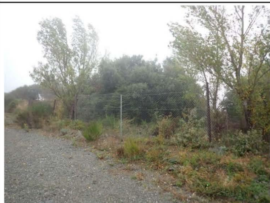
Illustration 40 : Portion de grillage remplacé en bon état
