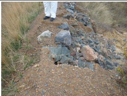
Illustration 9 : Merlon de protection dégradé en amont de la mare B2
